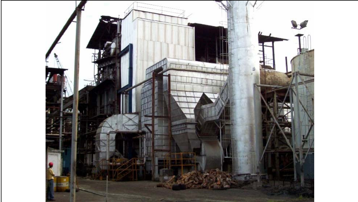
Figura 1: Caldera No 1 del Central Azucarero MOLIPASA, Edo Portuguesa, Venezuela. Caldera con domos para 36kg/cm 2 que operaba a 21kg/cm 2 . Se modificaron el sobrecalentador y el recorrido de los gases en el banco de tubos. Se añadieron dos etapas de calentamiento de aire, un economizador y un lavador de gases tipo spray tower para pasar de 55t/h, 21kg/cm 2 , 280°C a 90t/h, 31,6kg/cm 2 , 385°C con una eficiencia de 84-85% (VCB)
