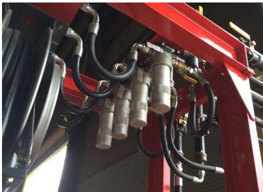
Sistema de filtración en punto de despacho.
