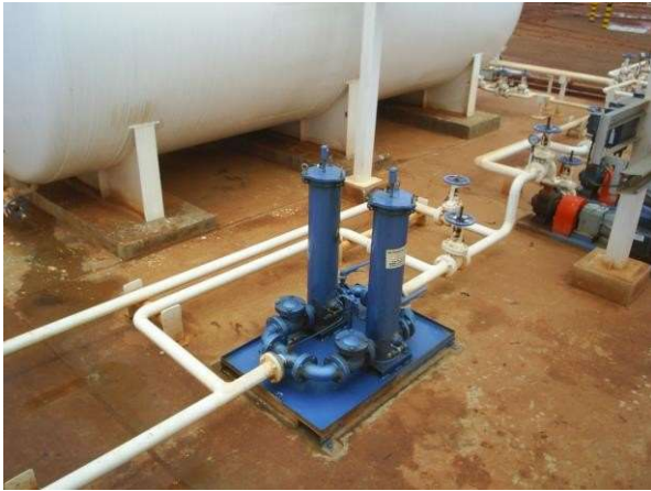
Sistema de filtración en línea.
