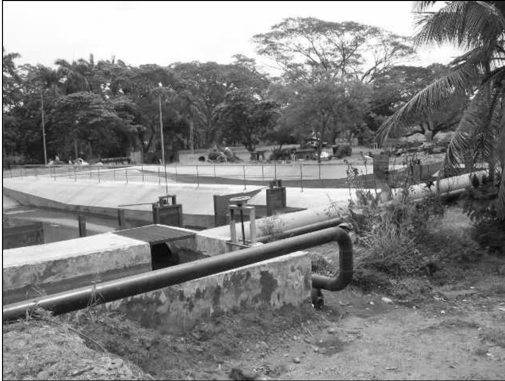
Foto #3. Tubería de recirculación de agua hacia la mesa de caña.
