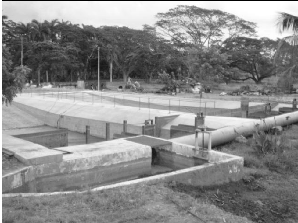
Foto #2. Sistema de sedimentación por gravedad para el agua de lavado de la mesa de caña.
