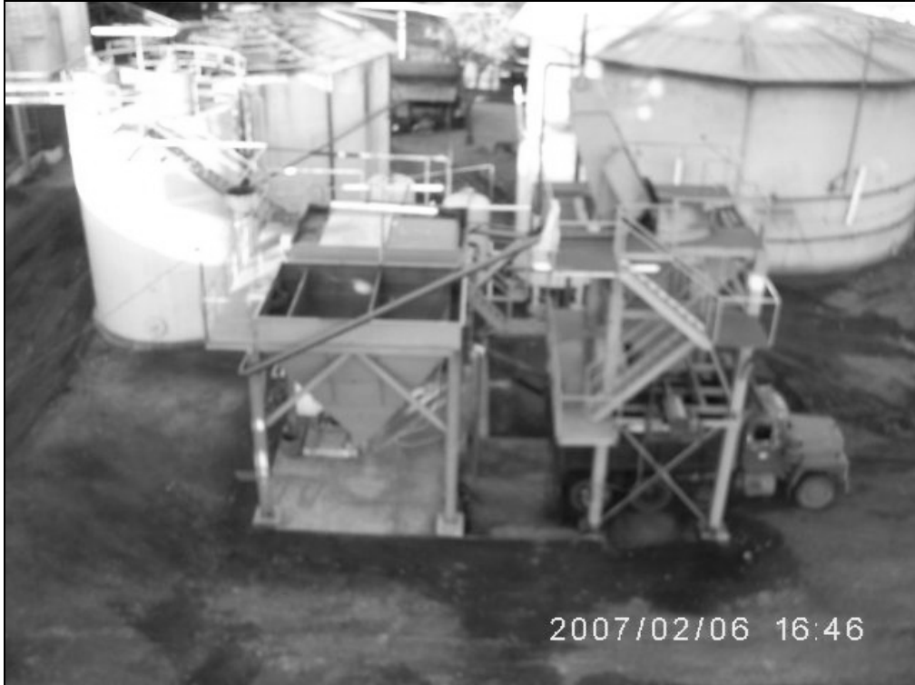
Foto #4. Sistema de sedimentación de cenizas.
