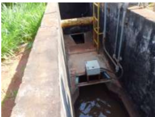
Figura 01 - Totalizador Parshall instalado en el canal de agua residual
