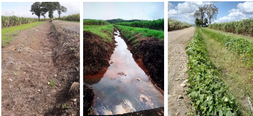
Figura 43. Drenaje superficial abierto para evacuación de aguas. Uso de mucuna.
