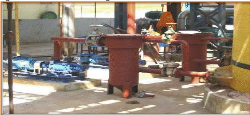
Fig. 7: Sistema de Filtración de Aguas condensadas
